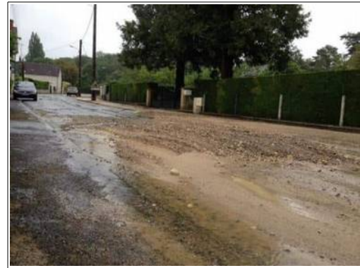
Chisseaux : des dégâts importants.
