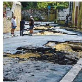
VERNOU-SUR-BRENNE. Le ruissellement a été d'une telle puissance que la rue Neuve a été complètement dévastée.
